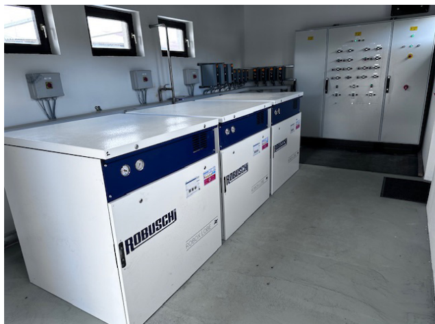
4. kép A fűvógépház az új fűvókkal, kapcsolószer- rényvel, fordulatszám szabályozókkal
