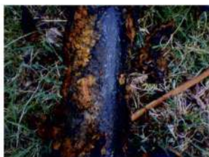
7. kép korrodált cső
