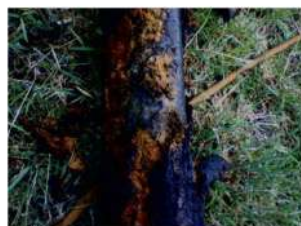
6. kép korrodált cső
