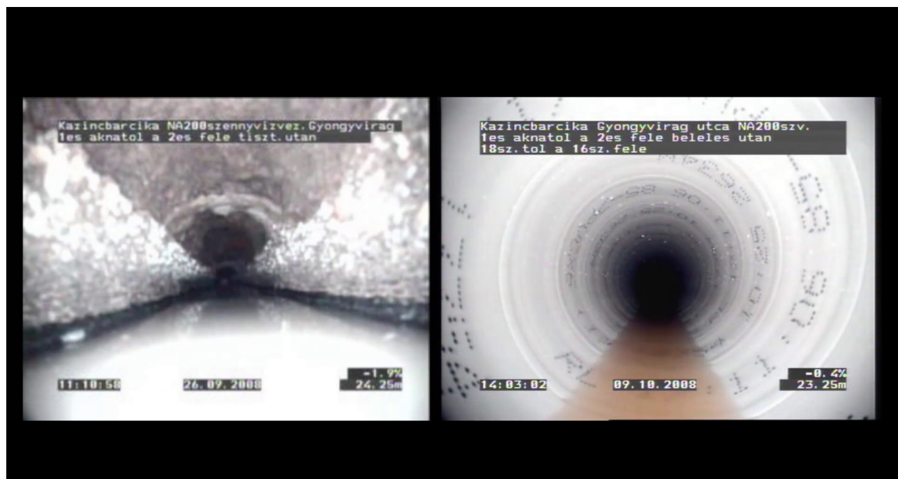
5. sz. fotó Csőfalhiányos csatorna bélés előtt és után
