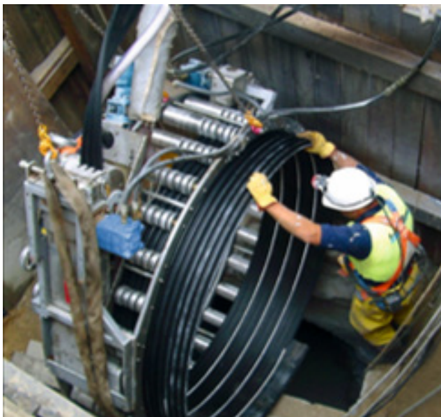
10. sz. fotó Ribline berendezés csőgyártás közben
